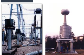
変電所の地震被害
