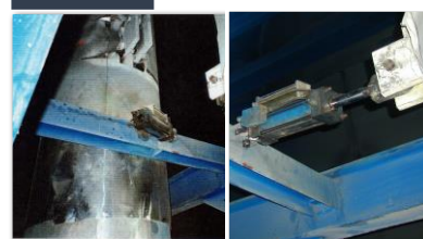
火力発電所の地震被害の一例
